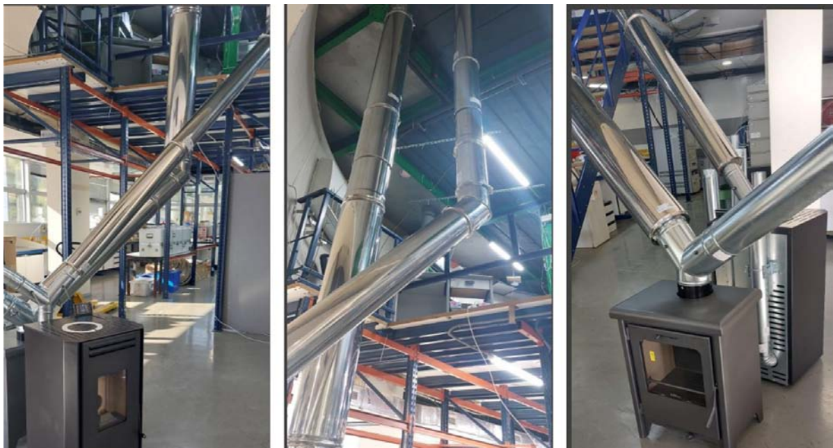
Figura EUPH4: Estufas de madera y pellets instaladas en el laboratorio y acopamiento a la instalación EUPHORE.
