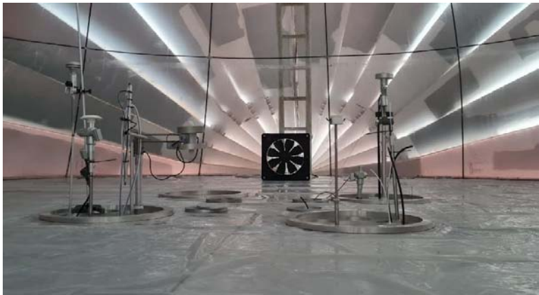
Figura EUPH2: Interior de la cámara EUPHORE con equipos instalados para la medida de aerosoles asociados a la quema de biomasa
